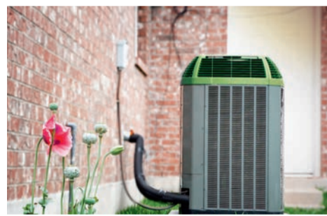
Energie – ganz einfach aus Luft und Erdrreich.
